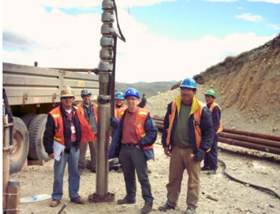
Installatie van een 130kW bore-hole pomp van 8 inch diameter op een diepte van 200 meter in de put. Pomp (van de concurrent nota bene) zit boven de motor (van ALJOP) gemonteerd en hangt aan de waterleiding.
